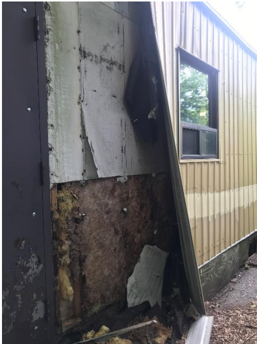
Photo 4831 – Dommages structuraux mur arrière
