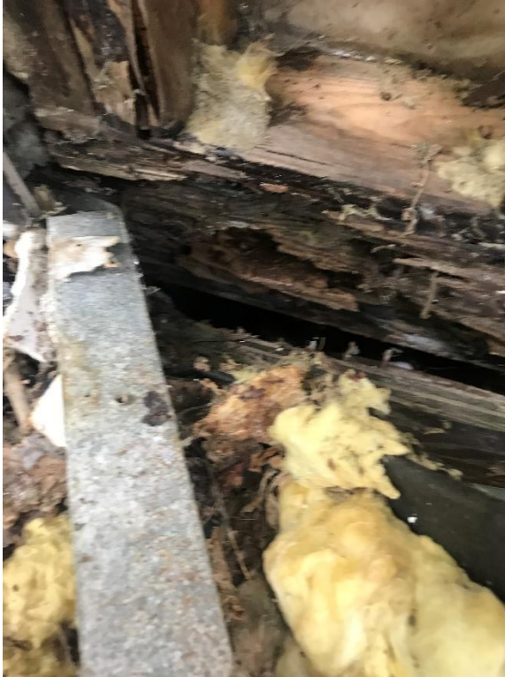
Photo 4829 – Dommages structuraux mur arrière
