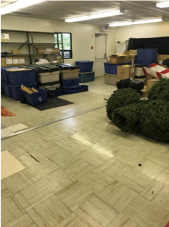
Photo 4840 – Dommages au plancher – dépression dans les solives et bosse à la poutre
