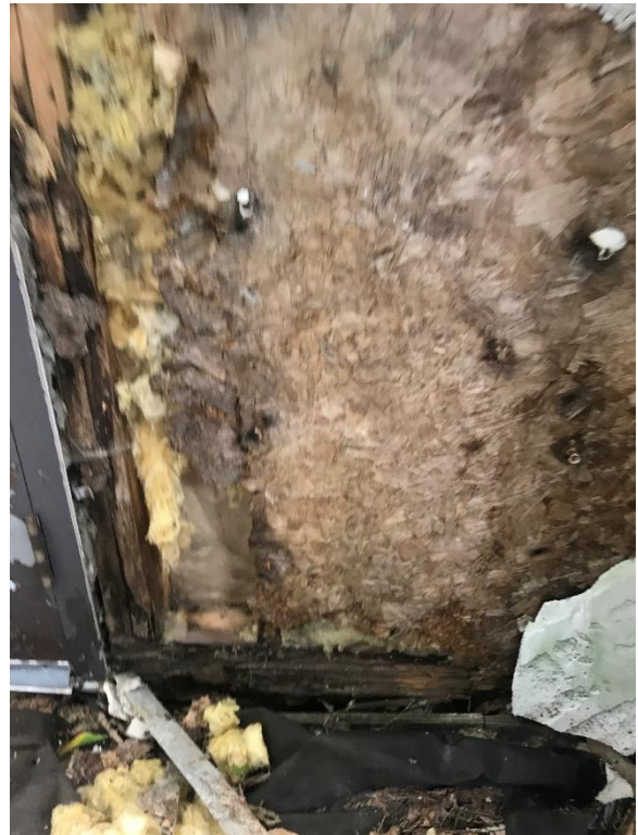
Photo 4828 – Dommages structuraux mur arrière
