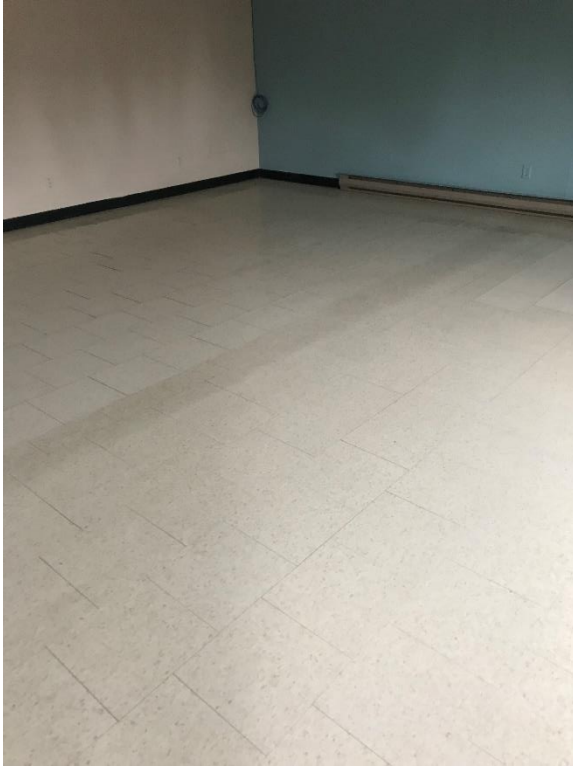
Photo 4839 – Dommages au plancher – dépression dans les solives et bosse à la poutre
